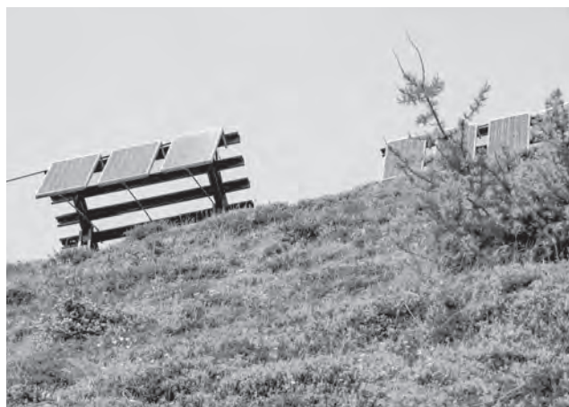
Photovoltaik auf Lawinerverbauung, 2012 Bellwald VS Lage: 2380 m ü. M. Fläche: 78 m 2 Jahresproduktion: 18 MWh Betreiber: Enalpin Foto: Carmen Graf, WSL
